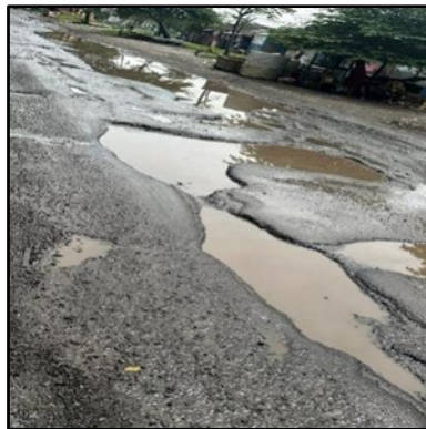
Gambar 2. Kondisi Jalan Berlubang
